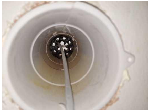
Kuva 5 Korvausilmaventtiilissä vähäisesti likaa.
