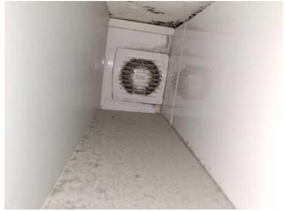
Kuva 7 Kanavassa oleva Extra-poistoilmatuuletin ja peltikanava on likainen.
