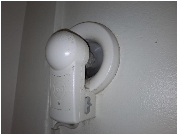
Kuva 8 Aikuisten wc-tilassa oleva PAX-poistoilmatuuletin.
