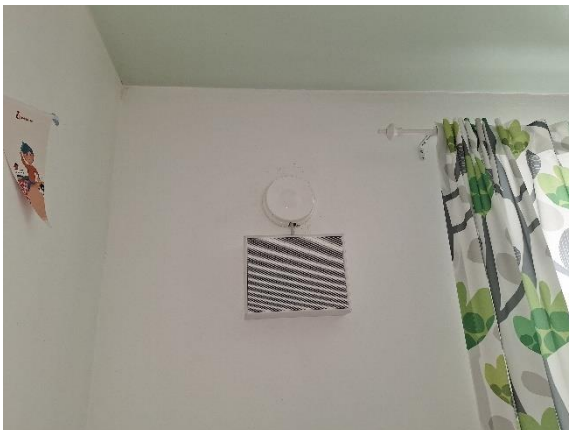
Kuva 4 Ruokailutilassa on korvausilmaventtiili.
