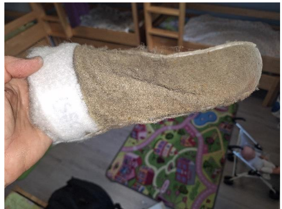
Kuva 3 Korvausilmalaitteen suodattimissa havaittiin likaa.
