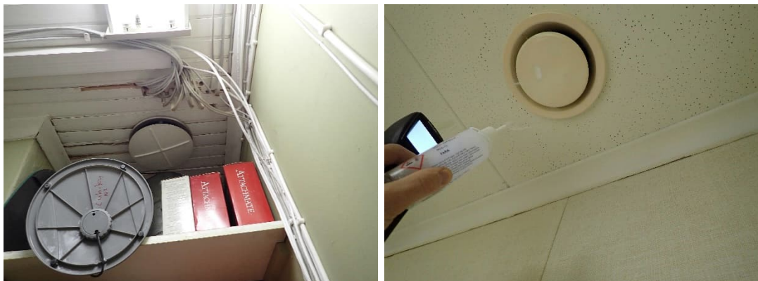
Kuva 38. Poistoilmaventtiileissä todettiin olevan poistoilmavirtaus merkkisavun avulla.
