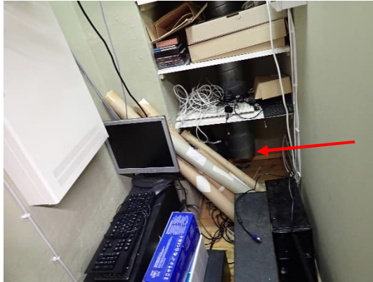
Kuva 39. Yläkerran serveritilaan on johdettu korvausilmaa kylmältä ullakolta.
