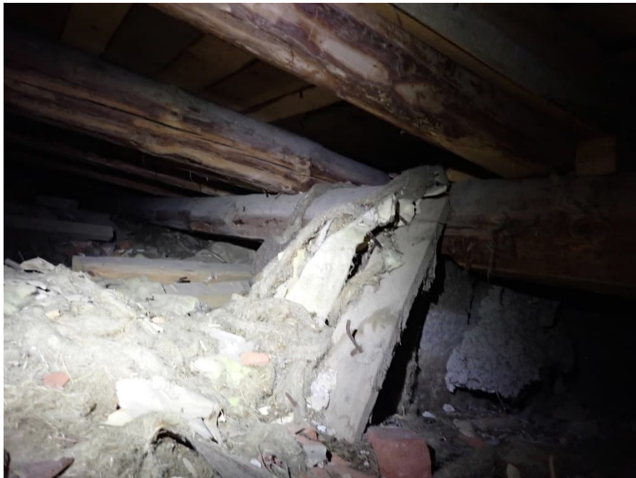
Kuva 6. Alapohjarakenteita oli paikoin pudonnut ryömintätien pohjalle.
