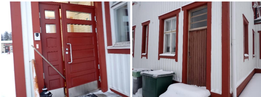
Kuva 29. Rakennuksen pääovi on uusittu ja se on hyvä kuntoinen. Muut ulko-ovet huonokuntoisia ja käyttöikänsä päässä.
