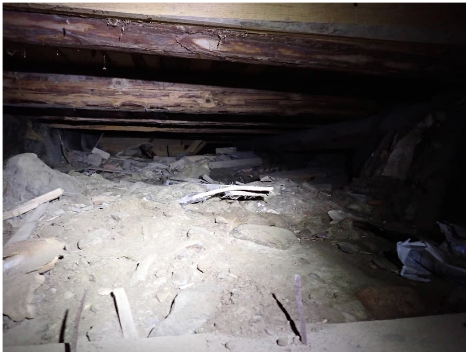
Kuva 4. Ryömintä oli matala eikä tilaa päästy kauttaaltaan tarkastamaan. Maaperä oli osittain jäässä tutkimushetkellä.
