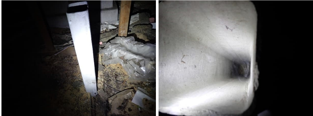
Kuva 33. Ullakotilaan nousi yläpohjarakenteesta asbestisementtikuitukanava, jonka sisällä oli purueristettä.
