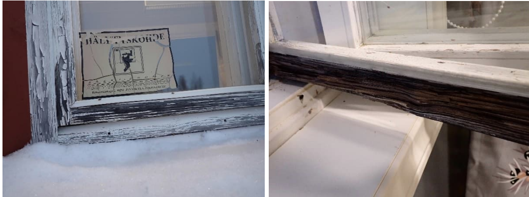
Kuva 21. Erityisesti lounaan ja etelän puoleiset ikkunat ovat huonokuntoisia. Ulkopuitteiden ja karmin alaosissa on lahovaurioita.
