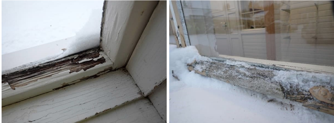
Kuva 27. Tuulikaapin alkuperäiset ikkunat ovat huonokuntoisia. Puitteiden alaosissa alkaa lahoamista ja haristumista. Maalipinnat monin paikoin kokonaan irti.
