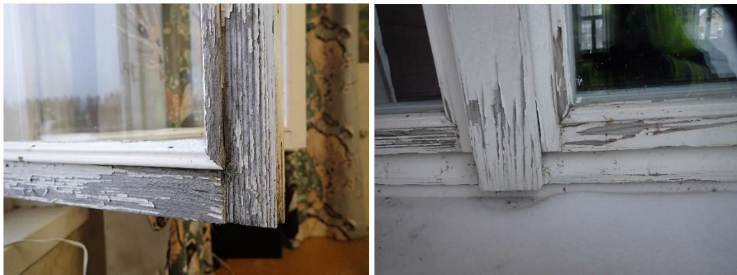
Kuva 23. Pohjoisen puolelle sijoittuvat ikkunat ovat hieman parempikuntoisia. Maalipinnat ovat varsin huonokuntoiset.
