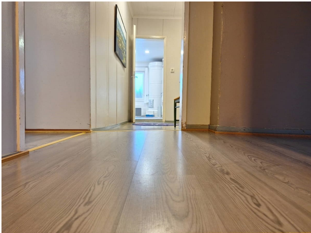
Kuva 10. Välipohjarakenteessa oli nähtävissä muodonmuutoksia (lattia hieman kupera).
