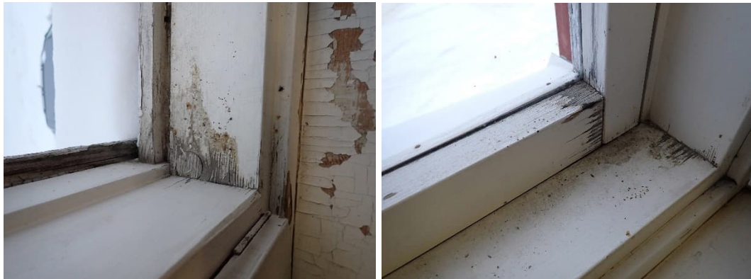
Kuva 24. Karmirakenteissa on maalin hilseilyä ja alkavaa haristumista.
