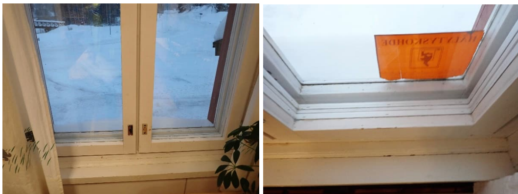
Kuva 26. Sisäpuitteissa on alkavaa maalin hilseilyä.
