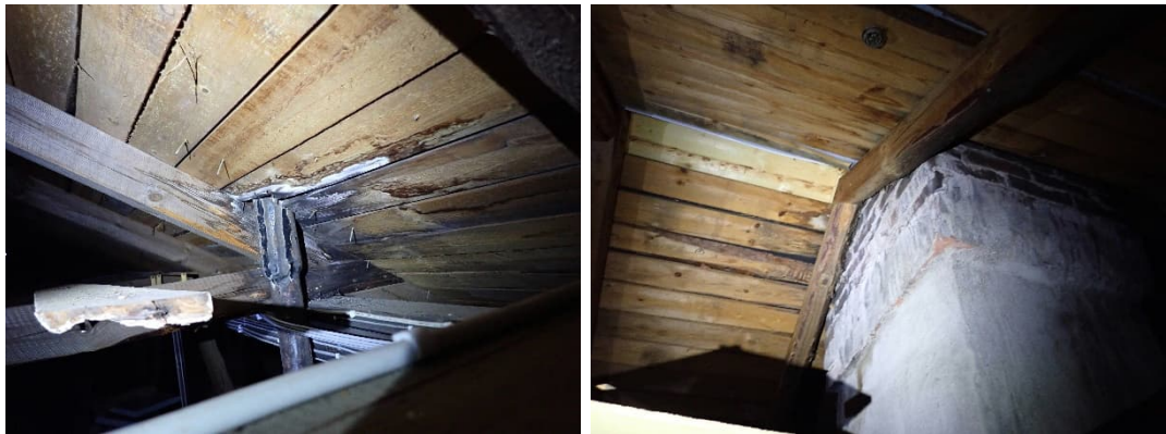
Kuva 34. Vesikattorakenteissa on vanhoja vuotojälkiä ja osa aluslaudoituksesta oli uusittu. Puurakenteissa ei havaittu kosteuspoikkeamia piikkimittarilla, mikä viittaa siihen, että vuodot ovat vanhoja.
