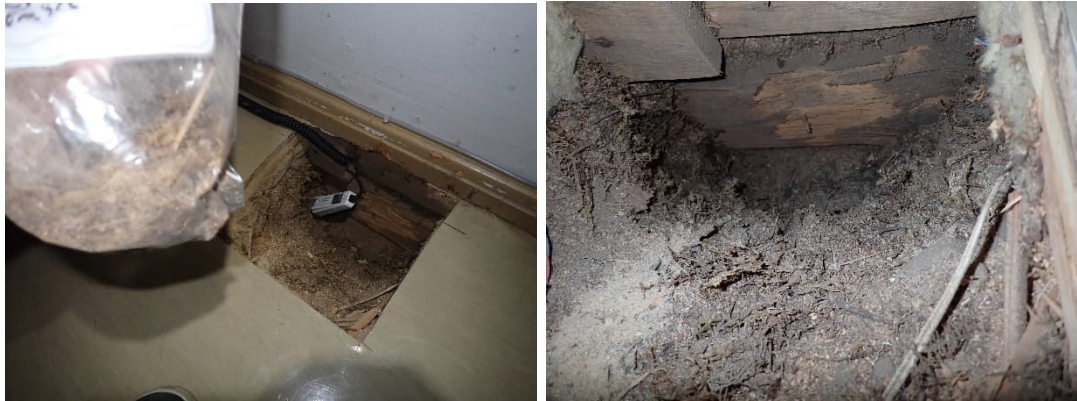
Kuva 7. Toisen toimiston alapohjaan tehdyssä avauksessa AP2 oli myös nähtävissä laho- vaurioita aluslaudoituksessa ja hirsiseinän alaosissa. Rakennekerrokset vastasivat ensimmäistä avausta.
