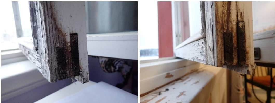
Kuva 22. Erityisesti lounaan ja etelän puoleiset ikkunat ovat huonokuntoisia. Ulkopuitteiden alaosissa on lahovaurioita.
