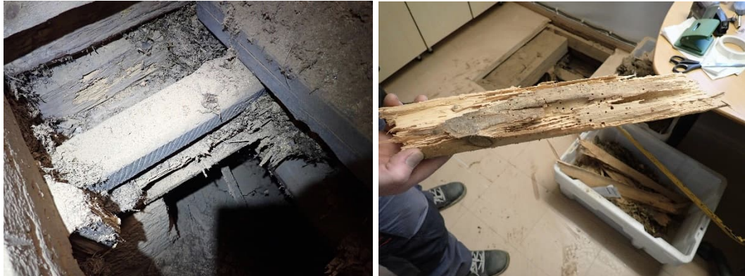
Kuva 19. Hirsirungon alimpia hirsiiä tarkasteltiin alapohjarakenteeseen tehdyn rakenneavauksen AP1 kautta. Hirsissä on selkeitä lahovaurioita.
