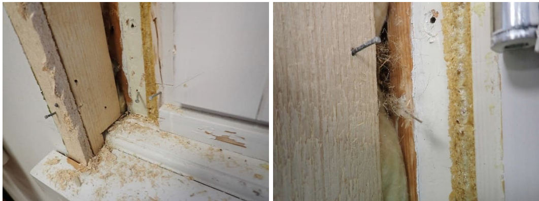
Kuva 28. Nykyiset ikkunat on asennettu vanhojen karmien väliin. Karmien liitos on eristetty uretaanivaahdolla. Vanhojen karmien tilkermateriaalina käytetystä riveestä otettiin materiaalinäyte.
