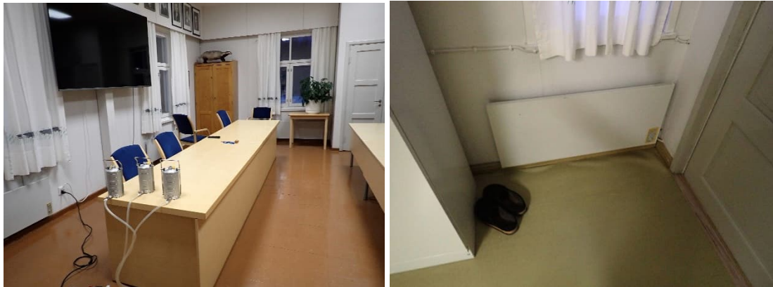
Kuva 2. Valtuustosalin lattiassa on huonokuntoinen vinyylilaatta pinnoite. Alakerran toisen toimiston muovimattopinnoite on paikoin kupruillut rakenteiden elämisen seurauksena.
