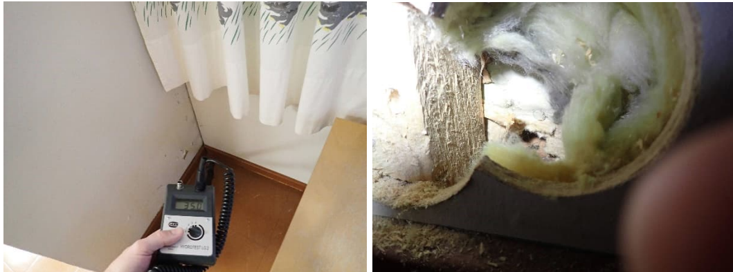
Kuva 13. Valtuustosalin luoteen puoleisella ulkoseinällä olevassa kivirakenteisessa kaapissa oli nähtävissä maalin hilseilyä. Rakenteissa ei havaittu kosteuspoikkeamia, mutta ulkoseinän liittymästä havaittiin voimakas kylmä ilmavirta joka viittaa rakenteen epätiiveyteen. Lisäksi ulkoseinäeristeessä oli ilmavuotojälkiä.
