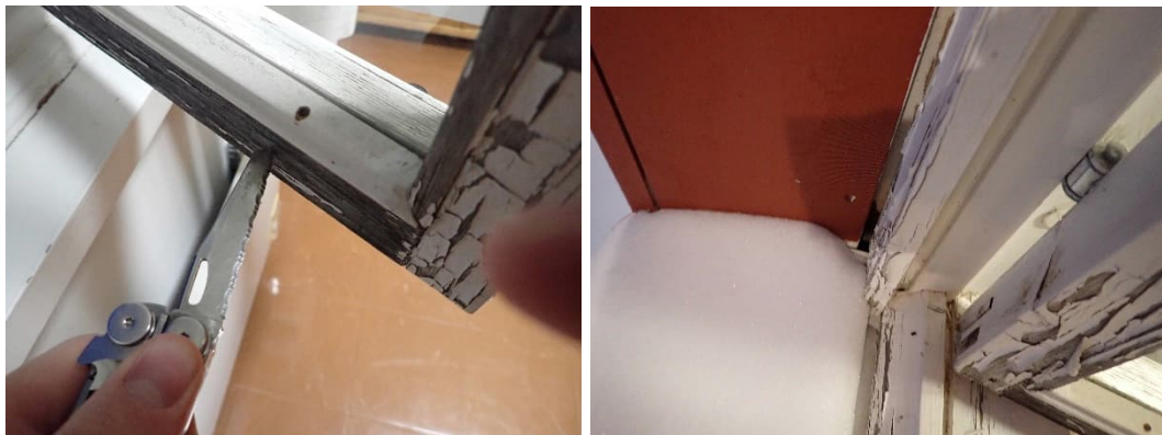
Kuva 25. Ikkunoiden ulkopuitteen ja karmin ulkopuolisissa puuosissa maalipinta oli huonokuntoinen. Myös lasituskittaus oli monin paikoin huonokuntoinen/olematon.
