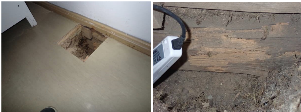
Kuva 18. Hirsirungon alimpia hirsiä tarkasteltiin alapohjarakenteeseen tehdyn rakennearon AP2 kautta. Hirsissä on selkeitä lahovaurioita.
