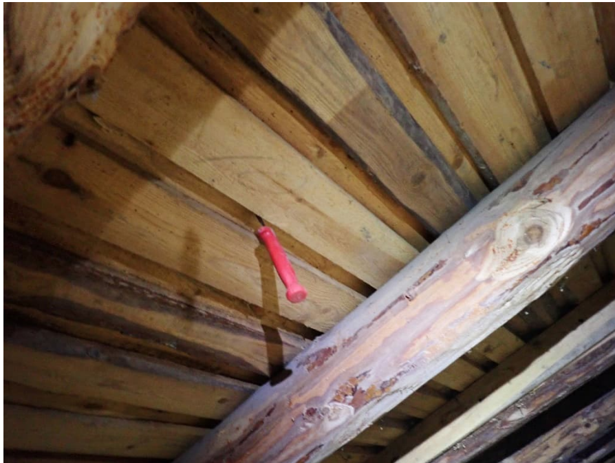
Kuva 5. Aluslaudoituksessa todettiin selkeitä lahovaurioita.
